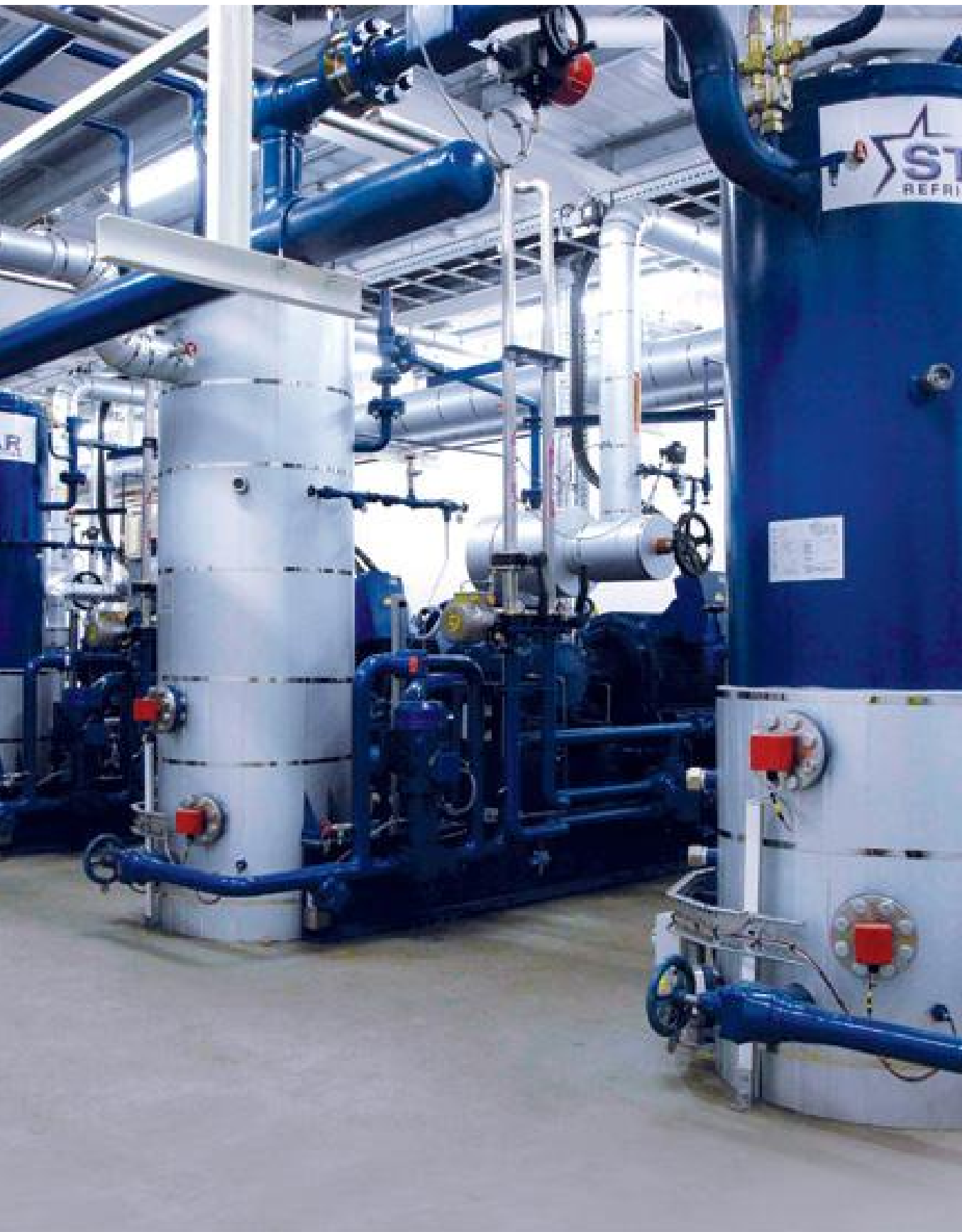
24. Warmtepomp system in de ARA en Augarten centrale energiecentrale ( www.constructionweekonline.com/ )
