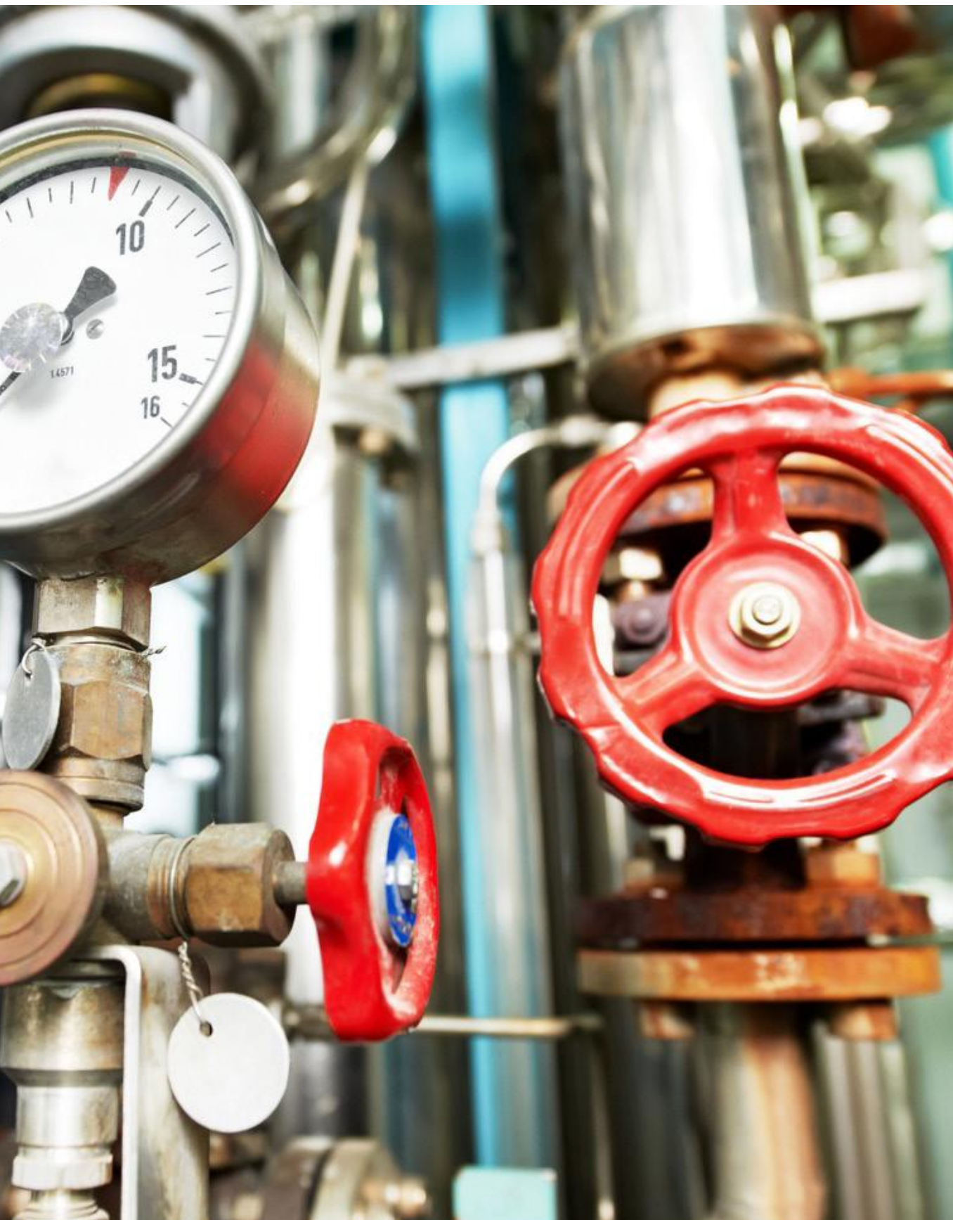
25. Detail van een warmteinstallatie ( armisteadmechanical.com )
