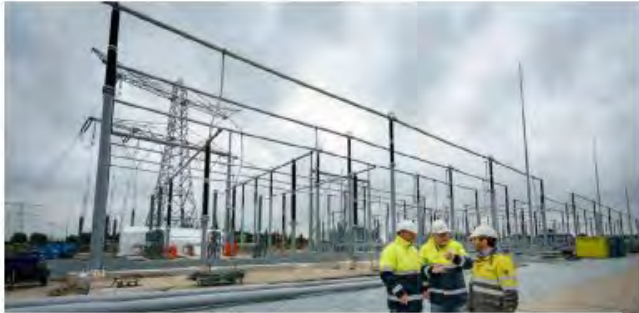
EHS-HS station (van 220-380 naar 110-150 kV)
