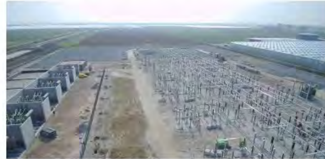
HS-MS station (van 110-150 naar 3-23 kV)
