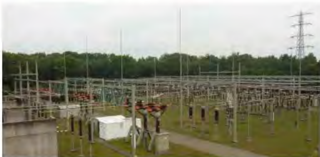
HS-TS station (van 110-150 naar 25-66 kV)
